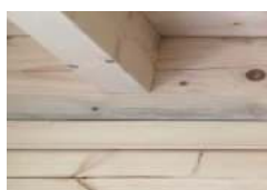
Moisissure et bleu:
